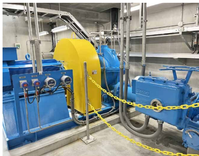
甲州市、山梨市、笛吹市で共同運営している峡東地域広域水道企業団が管理する水道施設に県が設置している小水力発電施設
